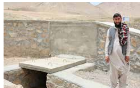
Qazi Hewadullah vid dräneringstunnlarna som ska leda om vattnet vid översvämningar.
